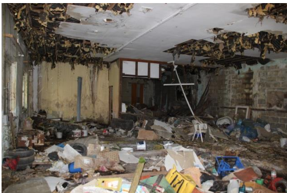
Einsturzgefährdeter Anbau eines herrenlosen Gebäudes. Foto: Landkreis Kassel
